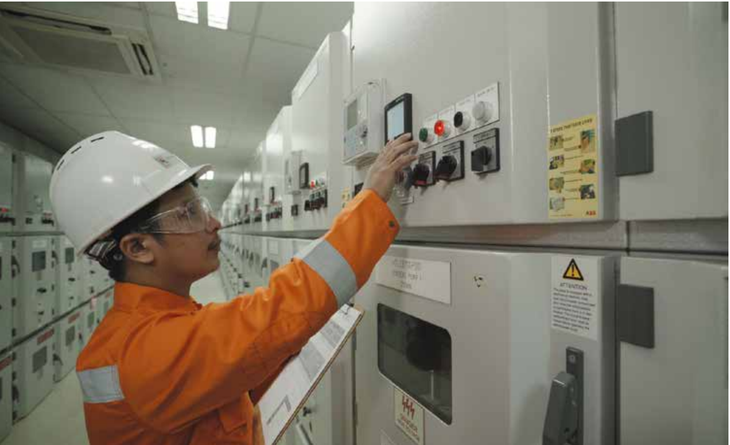
▲ Ruang Switchgear 6.3kV 6.3kV Switchgear Room
